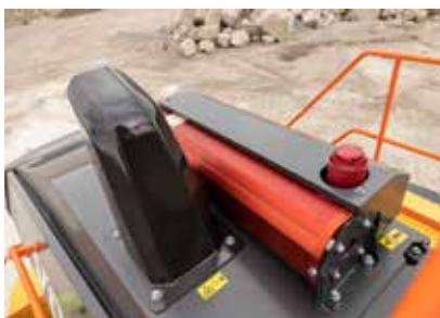
Sistema de extinción de incendios
